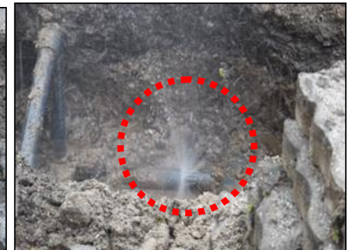
6.漏水箇所の発見!!
